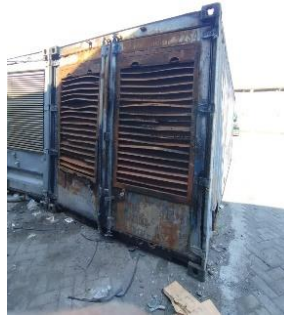
Gambar 4. 1 Kontainer Power Pack Terbakar
