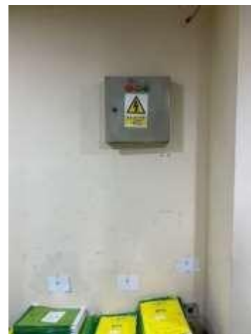
Gambar 1. 4 Tegangan Listrik Tinggi
