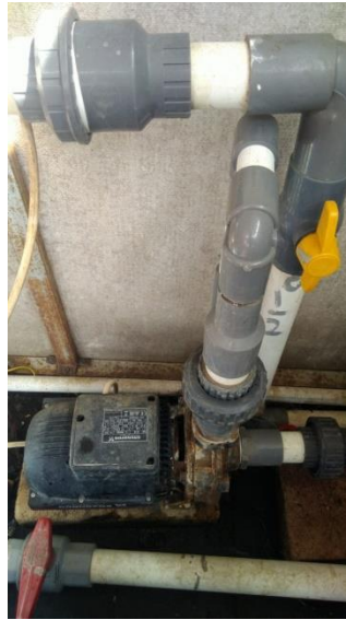
Gambar 4. 4 Mesin Pompa Air Baku
