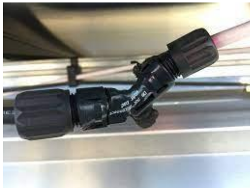
Gambar 5.17 MC4 meleleh pada panel surya (Sumber: Data Primer diolah 2022)
