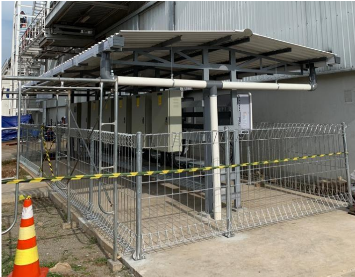
Gambar 4.23 Shelter PLTS (Sumber: ATW Solar)
