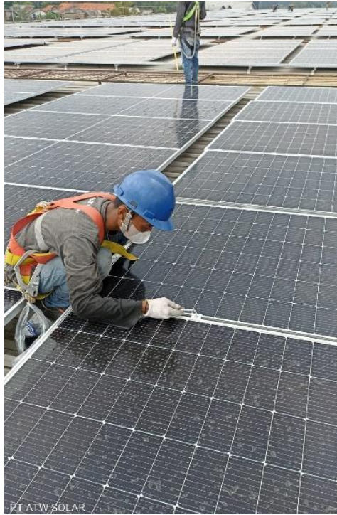
Gambar 5.3 Pemeriksaan Baut Komponen Pendukung Pada Panel Surya
