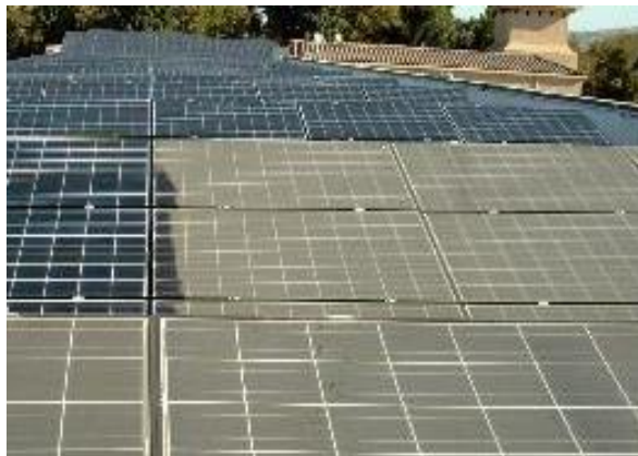
Gambar 5.2 Perbedaan PV yang Sudah Dibersihkan Dengan yang Belum Dibersihkan (Sumber: Maintenance PT ATW Solar)
