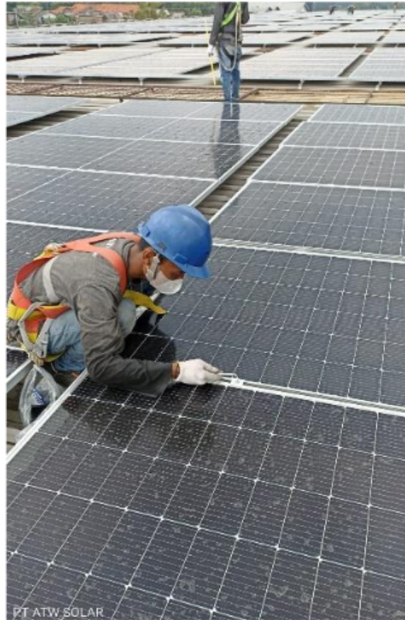
Gambar 5.3 Pemeriksaan Baut Komponen Pendukung Pada Panel Surya
