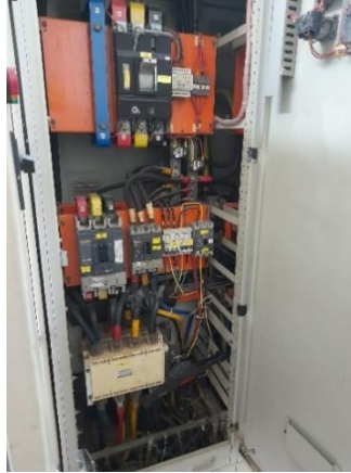
Gambar 3.10 MDB Room (Sumber: Dokumen Pribadi,2022)
