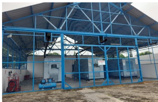
Gambar 3.9 EDG Room (Sumber: Dokumen Pribadi,2022)
