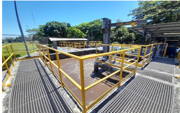
Gambar 3.20 SBR Tank (Sumber: Dokumen Pribadi,2022)
