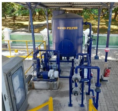
Gambar 3.21 Sand Filter (Sumber: Dokumen Pribadi,2022)
