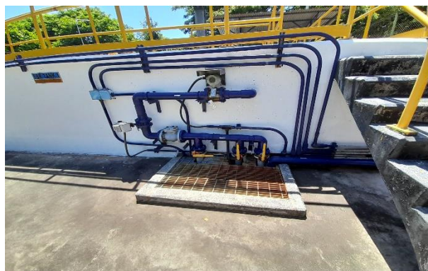
Gambar 3.19 Holding Tank (Sumber: Dokumen Pribadi,2022)
