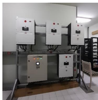
Gambar 3.16 Inverter (Sumber: Dokumen Pribadi,2022)
