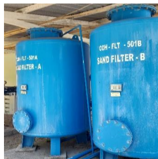
Gambar 3.12 Sand Filter (Sumber: Dokumen Pribadi,2022)
