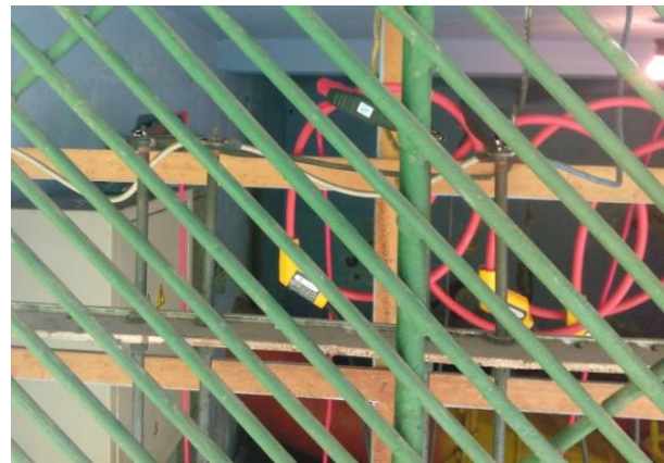
Gambar 1. Clamp dan probe power logger yang terpasang di Mikrohidro Gunung Sawur 1 Lumajang
