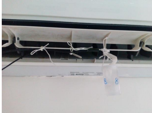
Gambar 4: Pemasangan sensor suhu udara yang keluar dari evaporator
