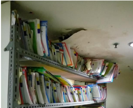
Gambar 1.1 Kondisi Langit-langit yang Dirembesi Air
